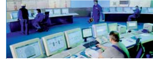
Leitstände des Kraftwerkes
